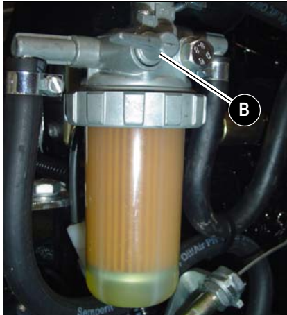
Fig. 4: Filtro de combustible
