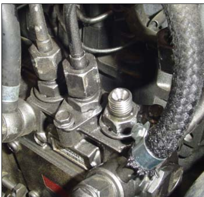
Fig. 8: Orificio en la bomba de inyección
